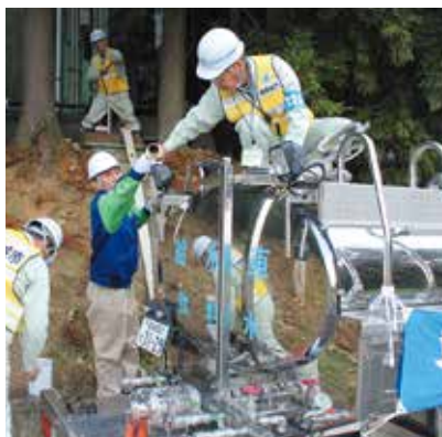
給水車への飲料水補給
