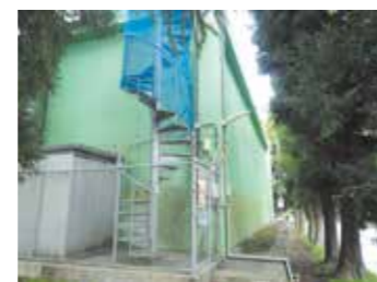
市川配水池：市川
