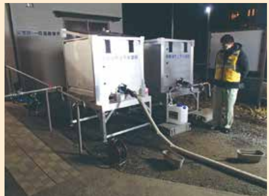
応急給水タンクを設置した給水所
