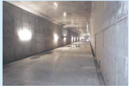
雨水調整池（八幡第二雨水調整池）
