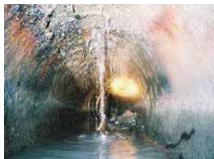
老朽化した下水道管（イメージ）
