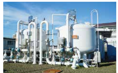
末の松山浄水場 (多賀城市八幡二丁目)
