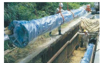
写真2：ポリエチレンスリーブ （管の防食を目的とした、筒型のポリエチレン製の被覆材）
