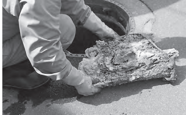
汚水管に詰まった油の塊
