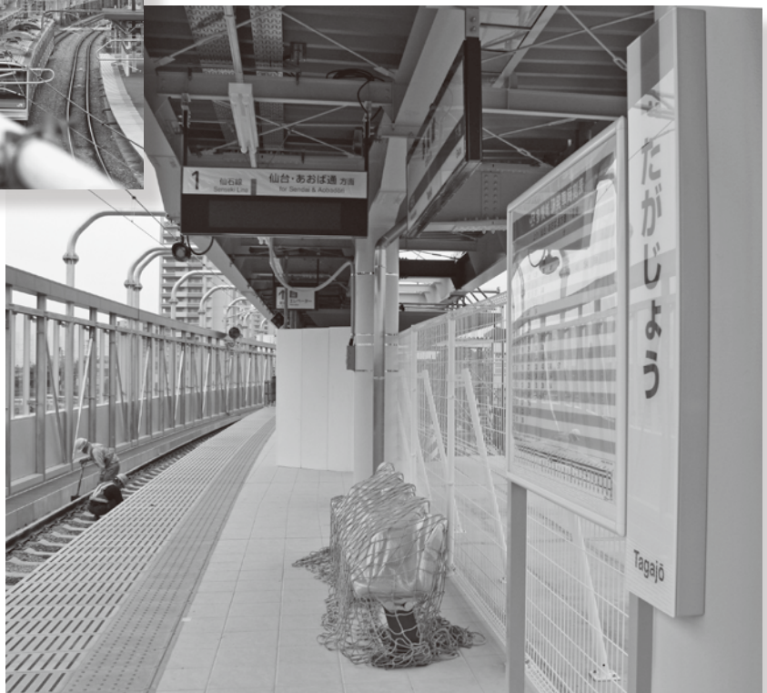
▲多賀城駅の新ホーム。上り線ホームが静かに利用の時を待っています。
