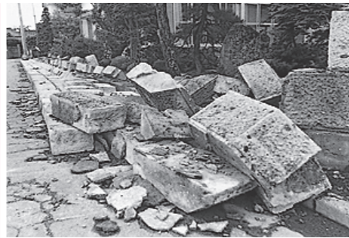
宮城県沖地震で倒壊したブロック塀
