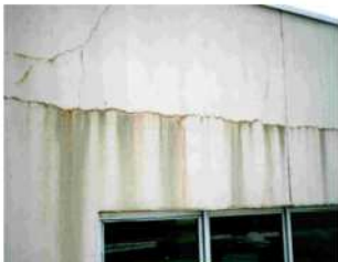
●外壁上部の外周部のひび割れ*2
