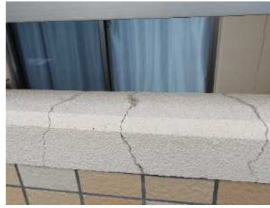
外壁 ひび割れ
