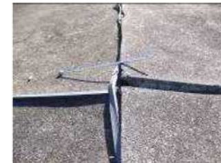
●押えコンクリートの目地のせり上がり*2
