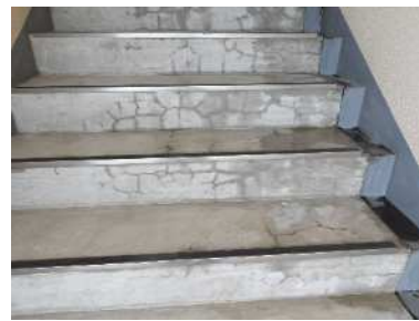
階段 ひび割れ
