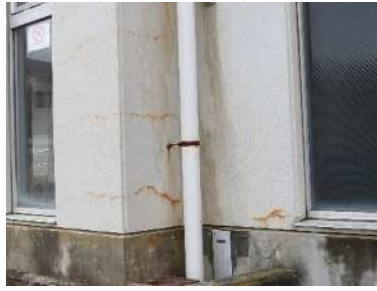
外壁 ひび割れ、サビ汁
