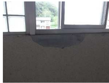
階段室 踊り場壁 塗装剥離
