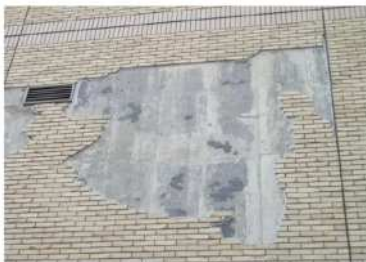
●タイルの剥落
