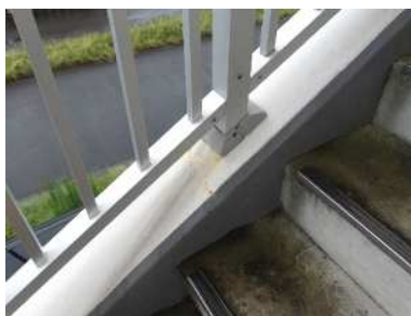
階段手すり下 ひび割れ
