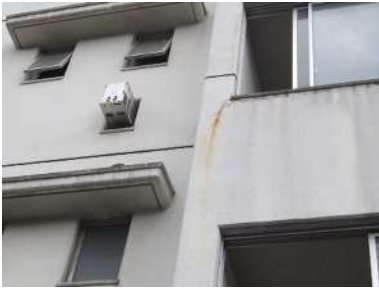
外壁 ひび割れ、サビ汁
