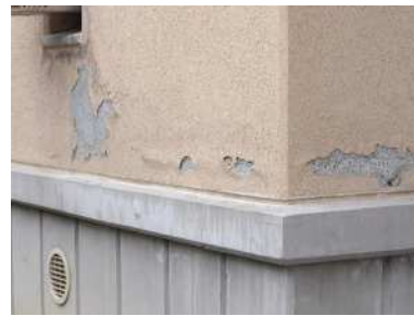
外壁 塗装剥離
