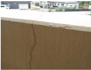
廊下手すり壁 ひび割れ、塗装浮き
