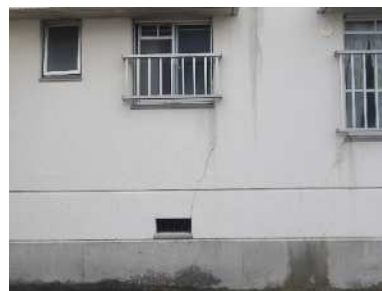
外壁 ひび割れ、汚れ（多数あり）
