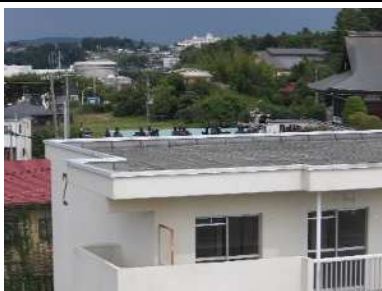
屋上 防水シートの劣化
