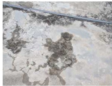
屋上 防水材のひび割れから雨水の染み
