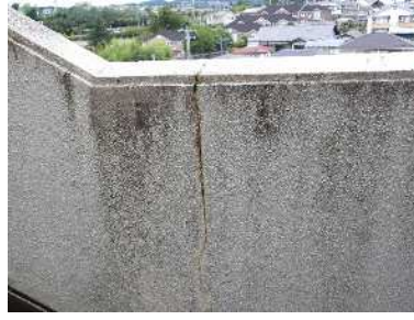
階段手すり壁 ひび割れ
