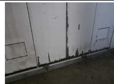
パイプスペース扉 塗装剥離
