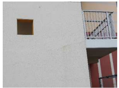
外壁 ひび割れ
