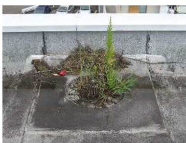
屋上 ドレイン植物繁茂
