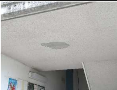
階段室入口天井 塗装剥離
