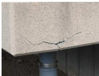
外壁 ひび割れ、浮き
