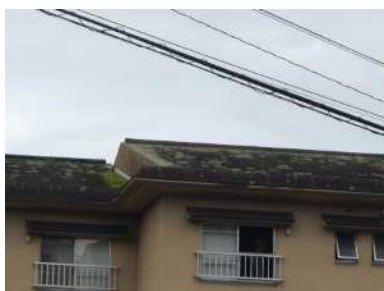
屋根 コケの繁茂
