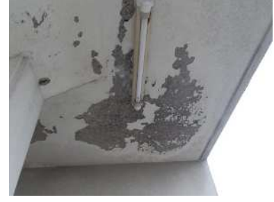
階段天井 塗装剥離
