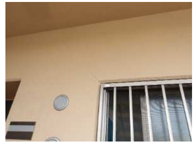
外壁 ひび割れ
