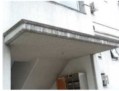
階段室入口庇 汚れ
