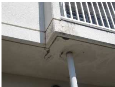
バルコニー天井 剥落、ひび割れ
