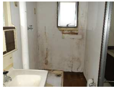
洗面所 壁紙剥がれ、カビ、汚れ
