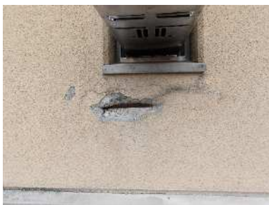
外壁 鉄筋露出
