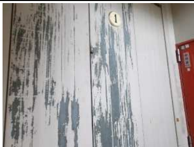
パイプスペース扉 塗装剥離
