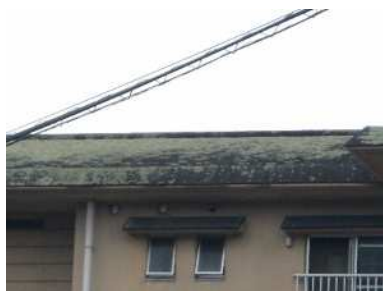
屋根 コケの繁茂
