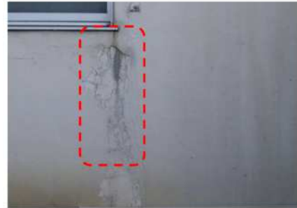
●塗り仕上げのはがれ
