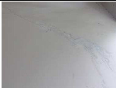
階段室壁 ひび割れ、塗装剥離
