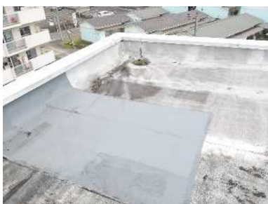
屋上 防水シートの浮き、たわみ
