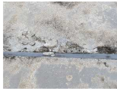
屋上 押えコンクリート広範囲の浮き、剥がれ
