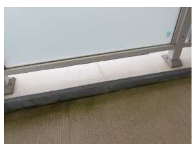
廊下 ひび割れ
