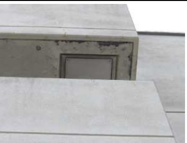
避難ハッチ サビ、ハッチまわり塗装剥離
