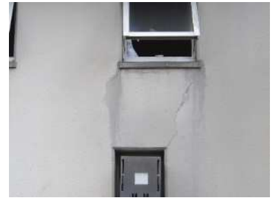
外壁 ひび割れ、汚れ
