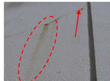
●ひび割れからの錆汚れ
