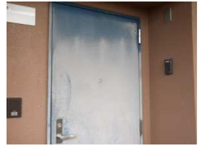
住戸扉 塗装劣化
