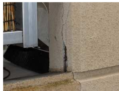
外壁 ひび割れ、鉄筋露出
