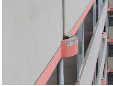
外壁 塗装剥離 多数あり
