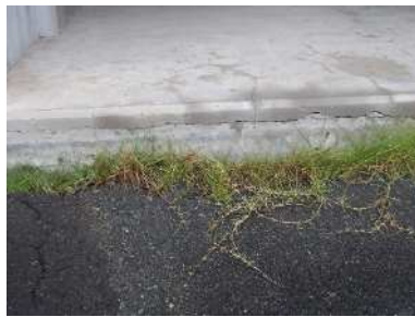
入口 コンクリートたたき ひび割れ
