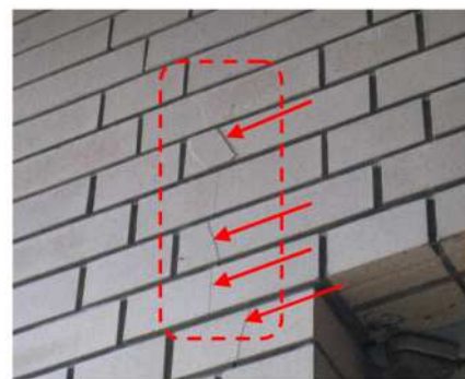
●タイルひび割れ
