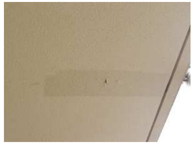
廊下天井 塗装剥離
