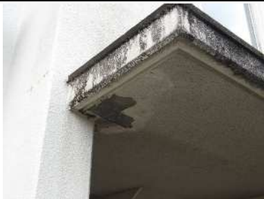
階段室入口 汚れ、塗装剥離
