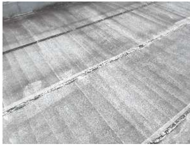
屋上 目地の劣化
