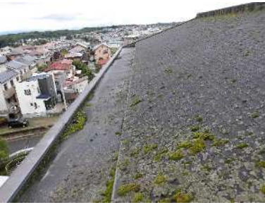
屋根 コケの繁茂
