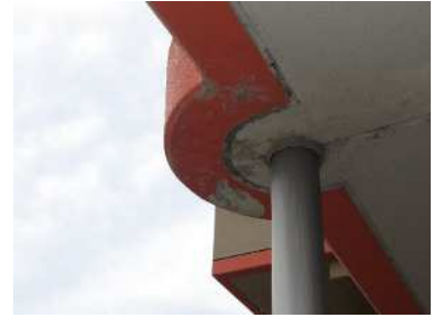
廊下天井 ひび割れ、塗装剥離 多数あり
