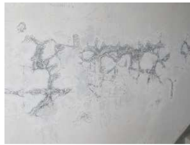
階段 壁のひび割れ
