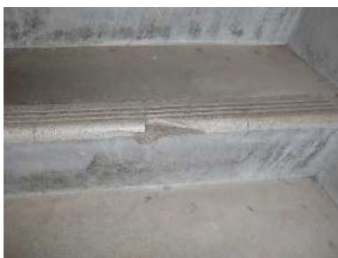
階段 ノンスリップタイル 破損
