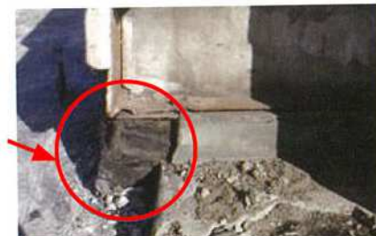
●立上り周辺部の欠損による防水層の露出*1
