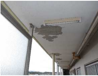
廊下天井 塗装剥離 (広範囲)
