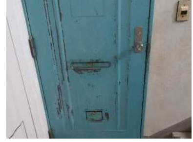
住戸扉 塗装剥離
