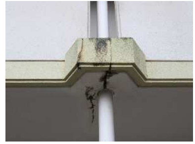
外壁 ひび割れ
