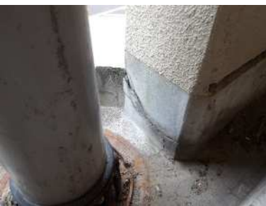
廊下排水まわり ひび割れ、浮き
