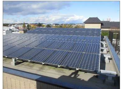
〈市役所屋上の太陽光パネル〉
