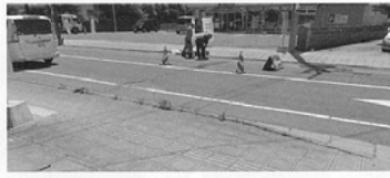
大代橋手前の県道がひび割れし、トラックの往來のたびに振動で家が揺れるとの訴えが。佐藤議員に党県議と調査し、県に改善を求め、すぐに路面の補修工事が実現しました。
