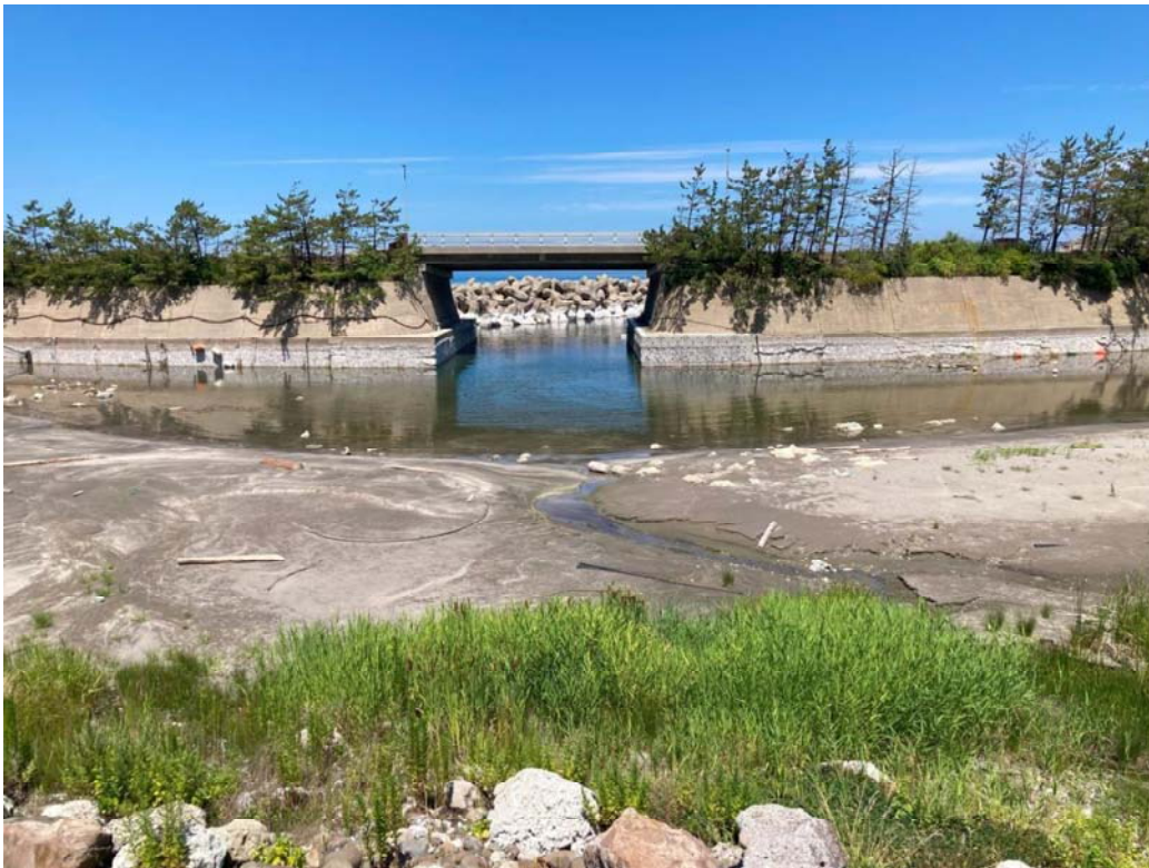
(隆起し、使えなくなった港 (珠洲市))
