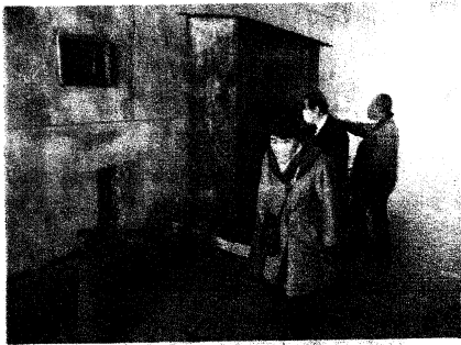
⑨通路に置かれた配電盤や水道管。
