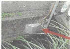
水位センサー設置(例)
