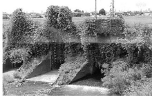
動かない3機の樋門
