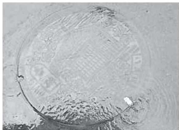
汚水があふれたマンホール
