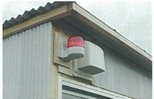
仮設住宅に設置されたパトライト
