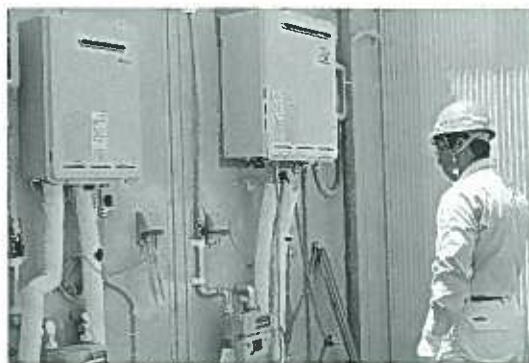
応急仮設住宅の給湯設備
