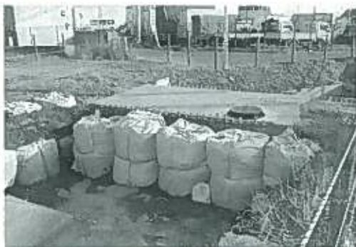
まだ応急処置段階の六貫田雨水幹線
