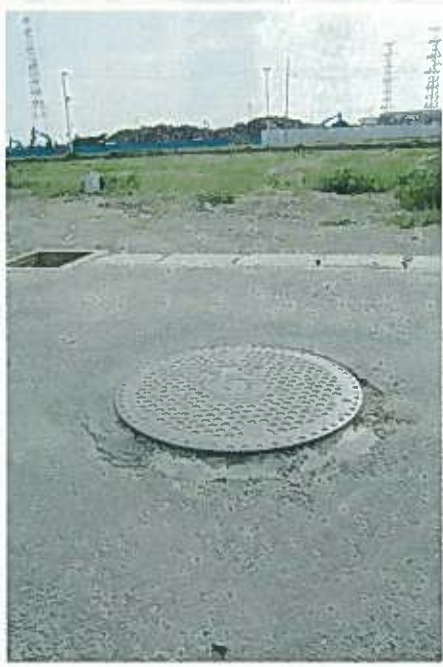
浮き上がったマンホール (宮内地区)
