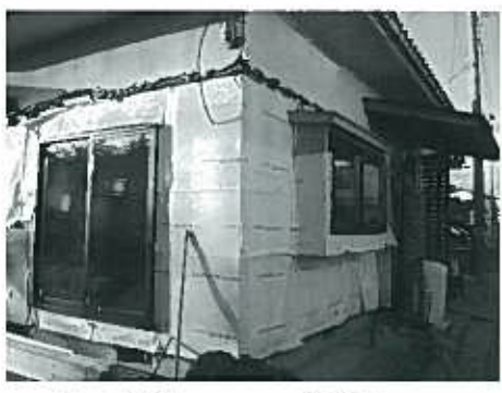
2階で生活している被災者宅
