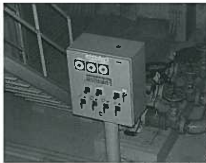
中央ポンプ場の操作盤
