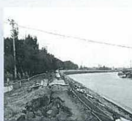
壊れた砂押川の堤防
