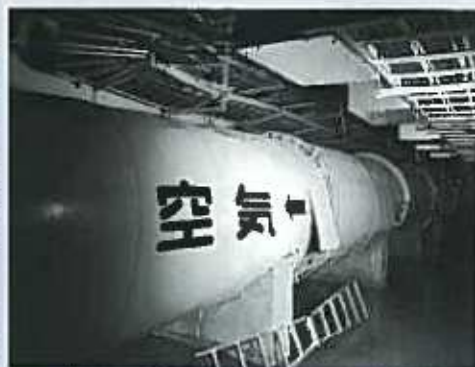
仙塩浄化センター内の被災状況
