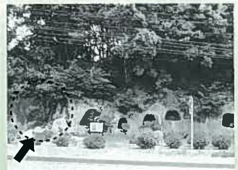
[近年崩落した横穴古墳] 多賀城市が誇れる貴重な古墳なので、大事に管理していきたいものです。
