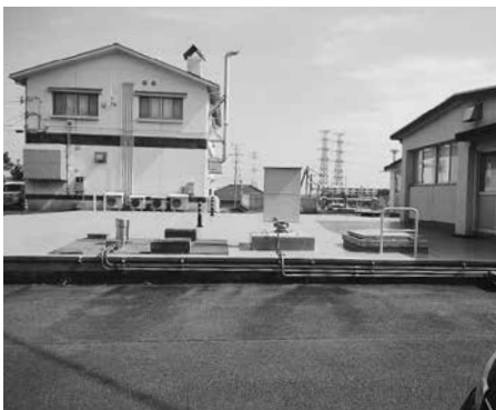
▲末の松山配水場
