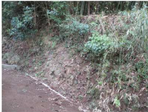
土砂流出(東門地区)
