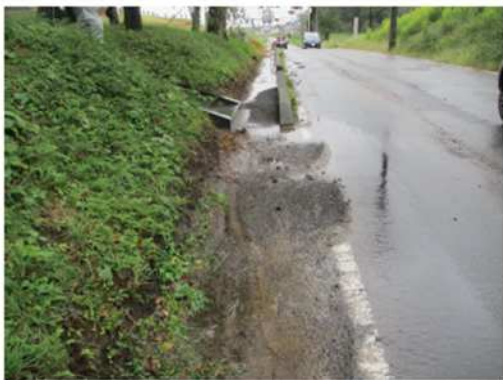
土砂流出(南門地区)
