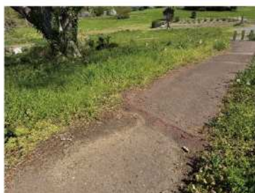
樹木根の被害(作貫地区)
