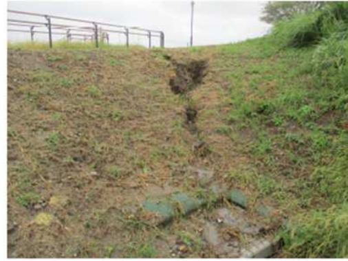
盛土亀裂(南門地区)
