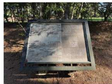
老朽化した説明板(多賀城廃寺跡)
