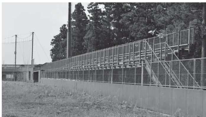
復旧工事が待たれる多賀城公園野球場
